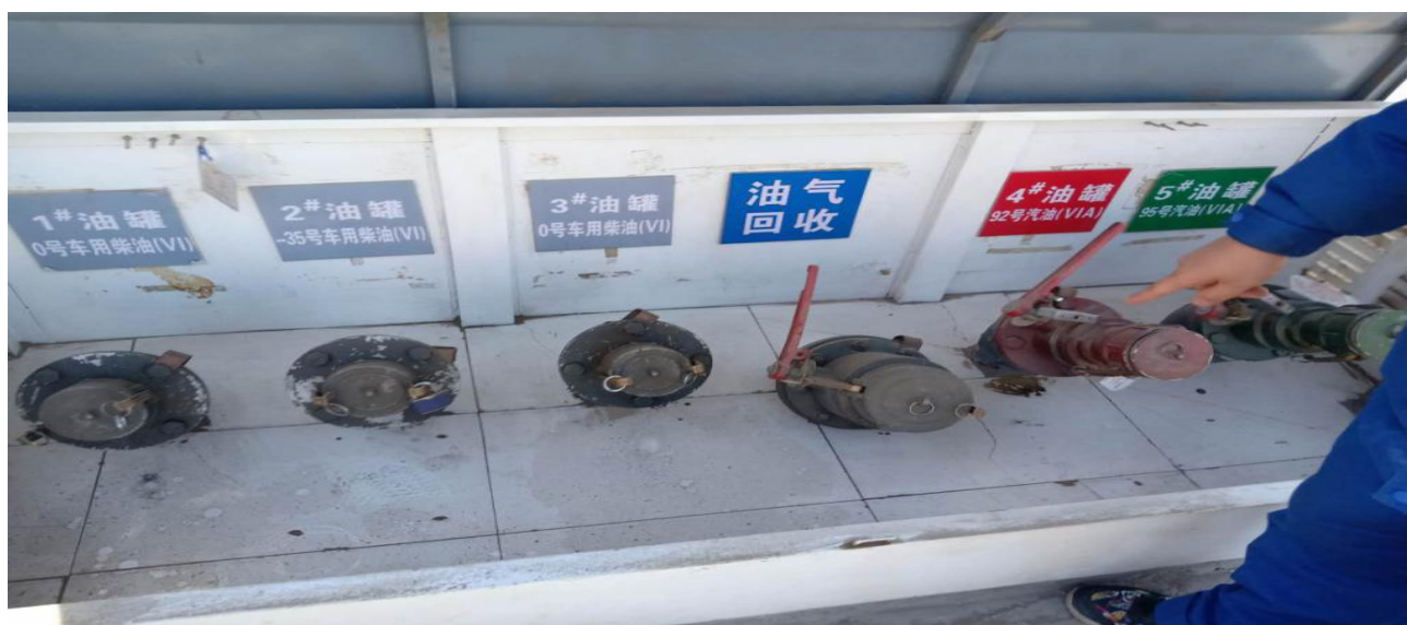
图 3.1 油气回收装置
