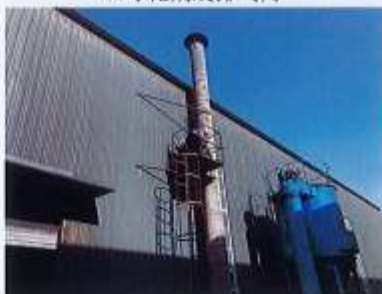
10#破碎孕育 2 号线排气筒
